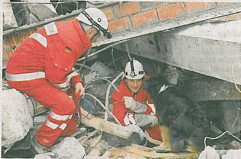
Abrissgelände sind ein ideales Testgebiet für die Unterländer Rettungshundestaffel, die am Klosterhof mit ihren Hunden zum Übungseinsatz unterwegs war.
