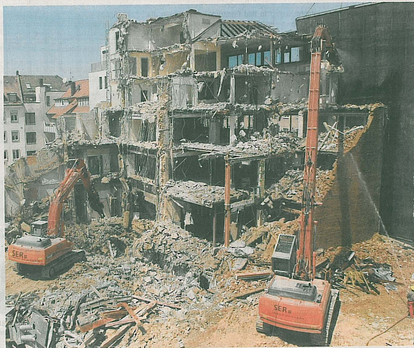
Der Abriss des Klosterhof-Geländes in Heilbronn war eine der spektakulärsten Arbeiten in der Region der vergangenen Jahre. Viele der anfallenden Bauschutt-Massen wurden zu neuen Materialien aufbereitet. Foto: Archiv/Veigel
