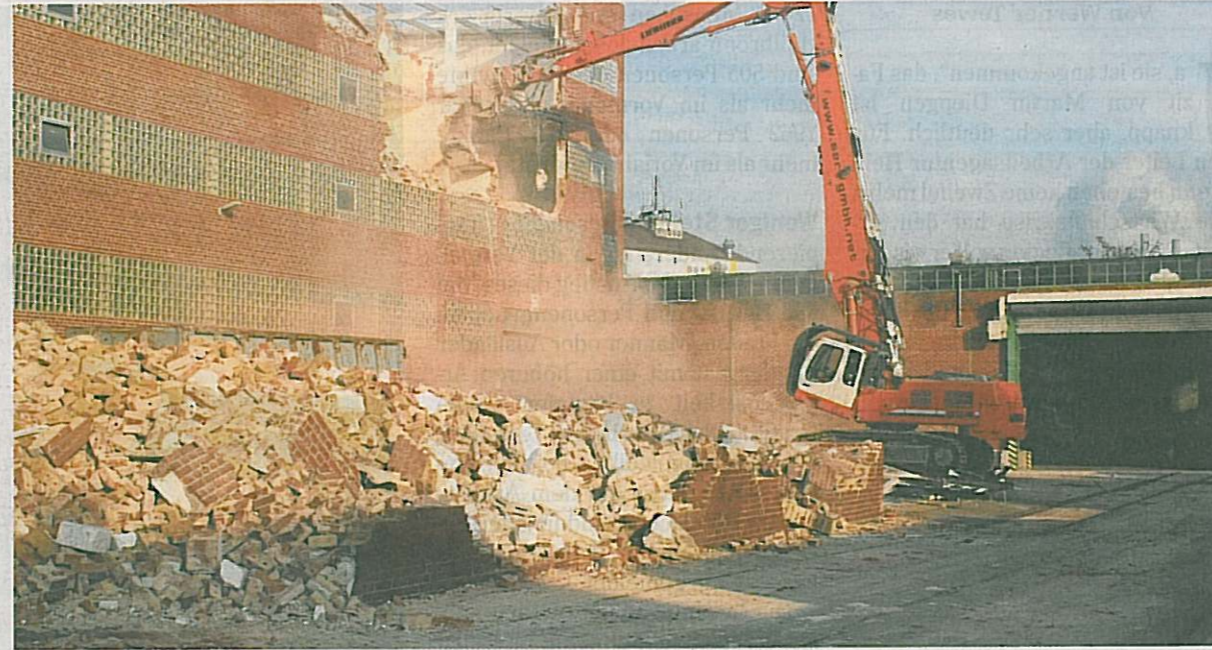
Unter Volldampf: Mit dem Bagger werden derzeit die Gebäude eingerissen. Bis spätestens Ende Juni sollen alle Abrissarbeiten beendet sein. Danach beginnt die Suche nach neuen Mietern für das Gelände. Fotos: privat
