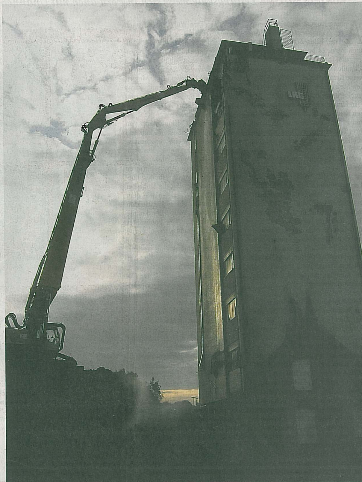
Endzeitstimmung: Die Tage des Siloturms sind gezählt. 50 Jahre lang prägte er das Öhringer Stadtbild mit. Innerhalb von zwei Wochen trägt ihn der Bagger ab – täglich rund vier Meter. Foto: Peter Hohl
